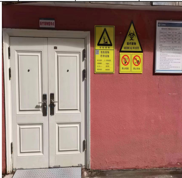
医疗废物暂存间
